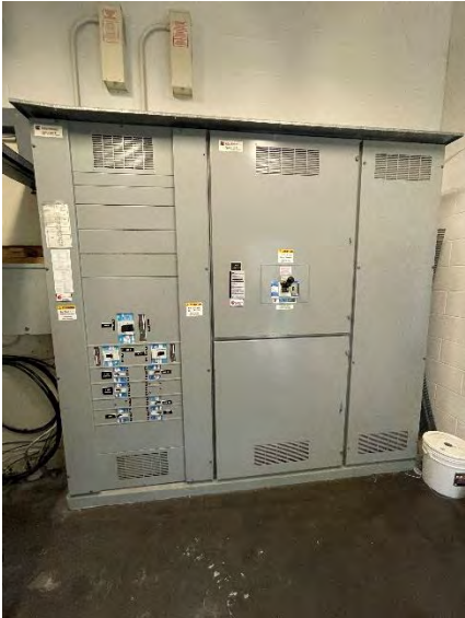
Photo 1 – 600V Main Switch/MDC
